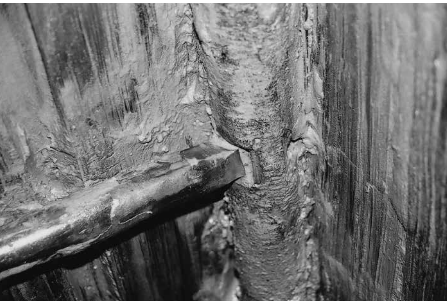
(3) B 2 地区第 2 面井戸 S E 230 横棧・隅柱接合状況(北西から)
