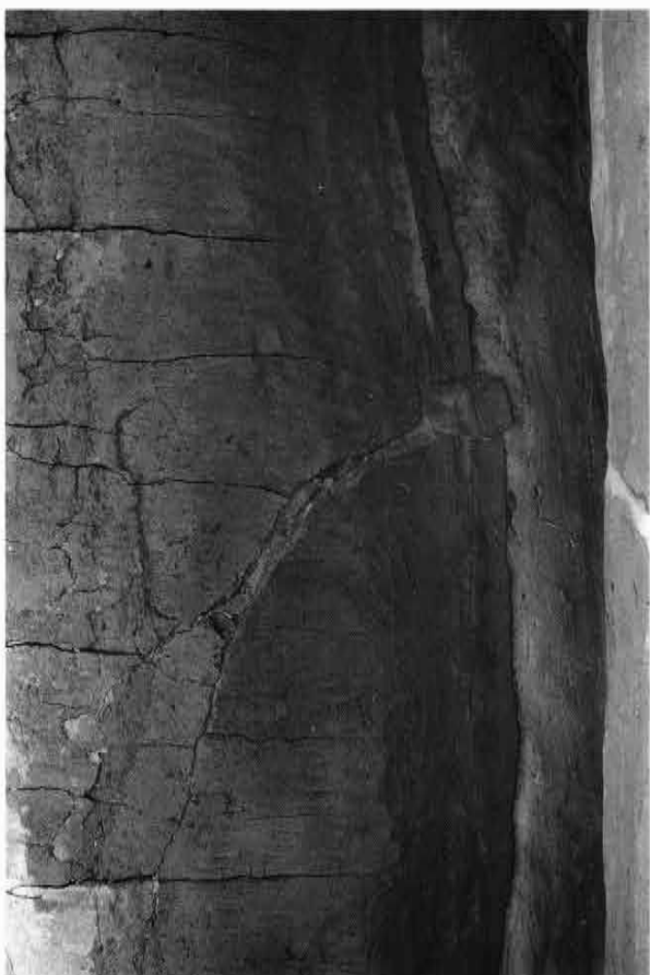
(1) トレンチ部東壁断面噴砂 (西から)
